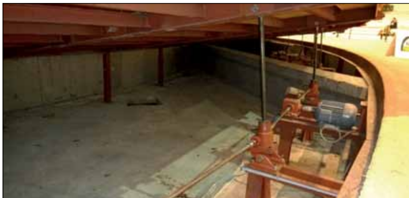
➤ Hipposhallissa on sähköhydrauli- sesti nostettavat kaarteet, 4 kiertä- vää rataa. Kuva: Kimmo Kylämies
