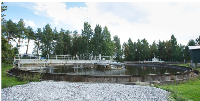
Kuva 13. Toikansuon jätevedenpuhdistamo, Lappeenrannan Energia Oy
