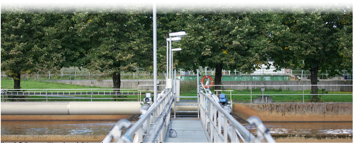
Kuva 1. Toikansuon jätevedenpuhdistamo, Lappeenrannan Energia Oy
