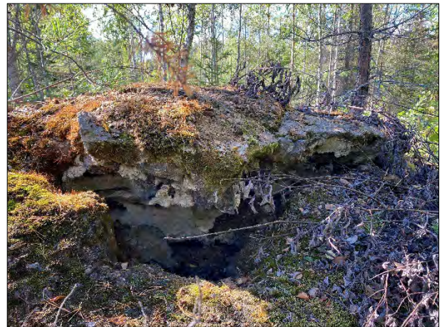
Kuva 353. Lemi Tauri-Elokallio. Toisen romahtaneen suojuhuoneen betonikate. Koillisesta.
