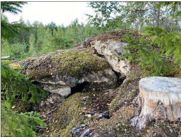
Kuva 352. Lemi Tauri-Elokallio. Romahtaneen suojuhuoneen betonikatetta. Etelästä.
