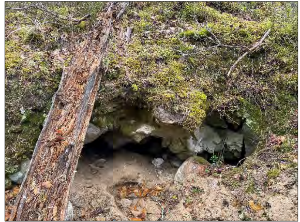
Kuva 337. Lemi Vuolteenkangas. Romahtanut suojahuone.
