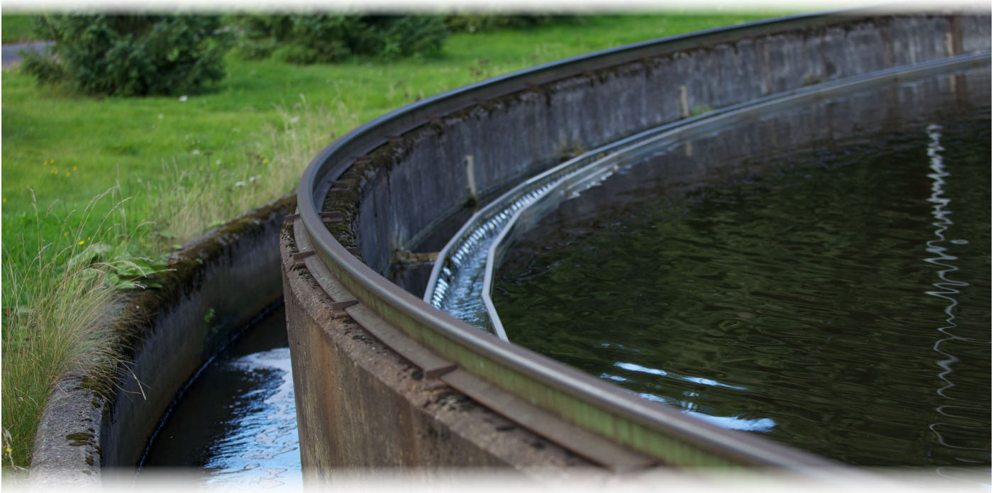
Kuva Toikansuon jätevedenpuhdistamo, Lappeenrannan Energia Oy.
