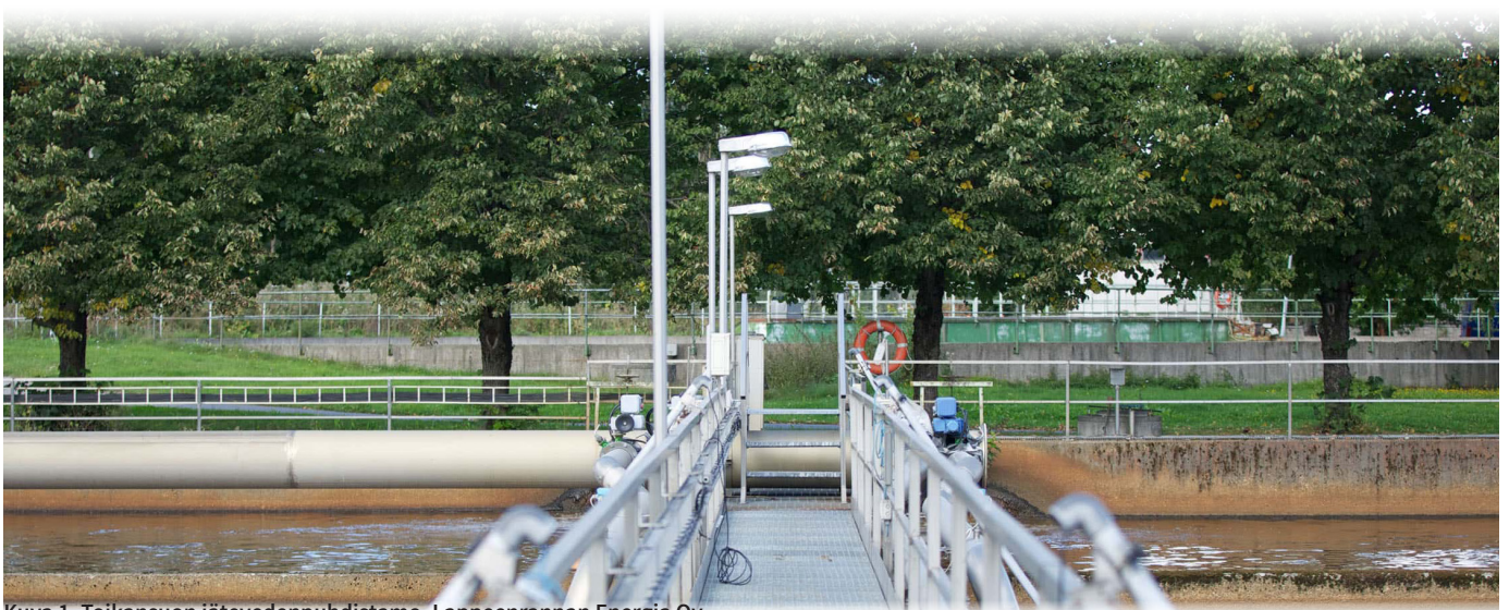
Kuva 1. Toikansuon jätevedenpuhdistamo, Lappeenrannan Energia Oy
